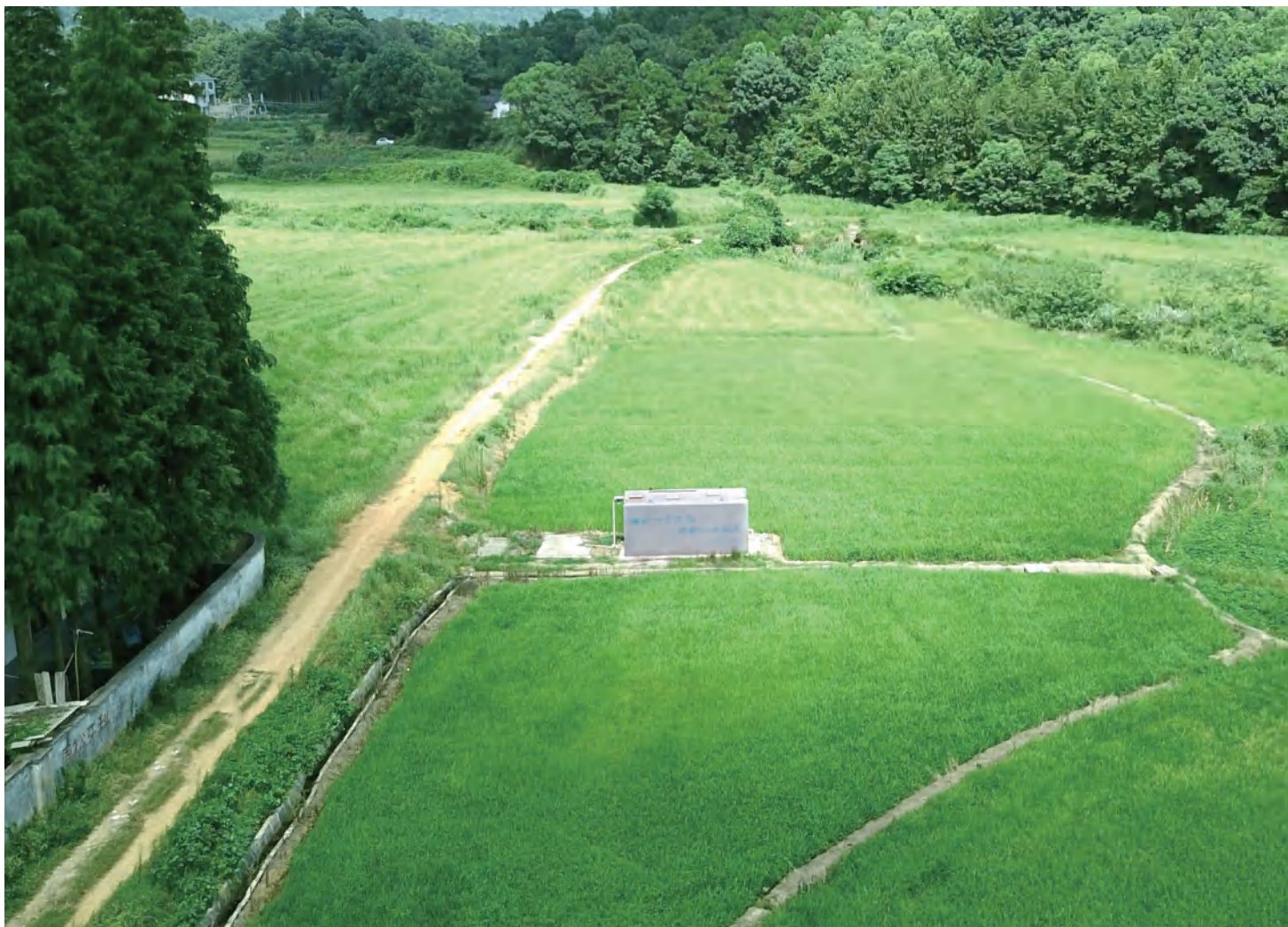
湘西花垣县十八洞村镇污水处理项目
